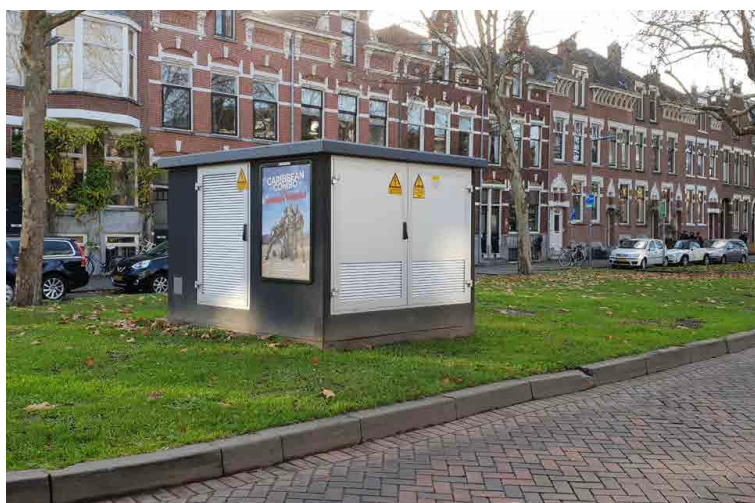
Figuur 17 - Voorbeeld van een transformatorstation
