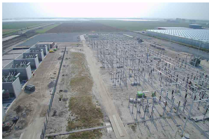
Figuur 19 - Afbeelding van een onderstation
