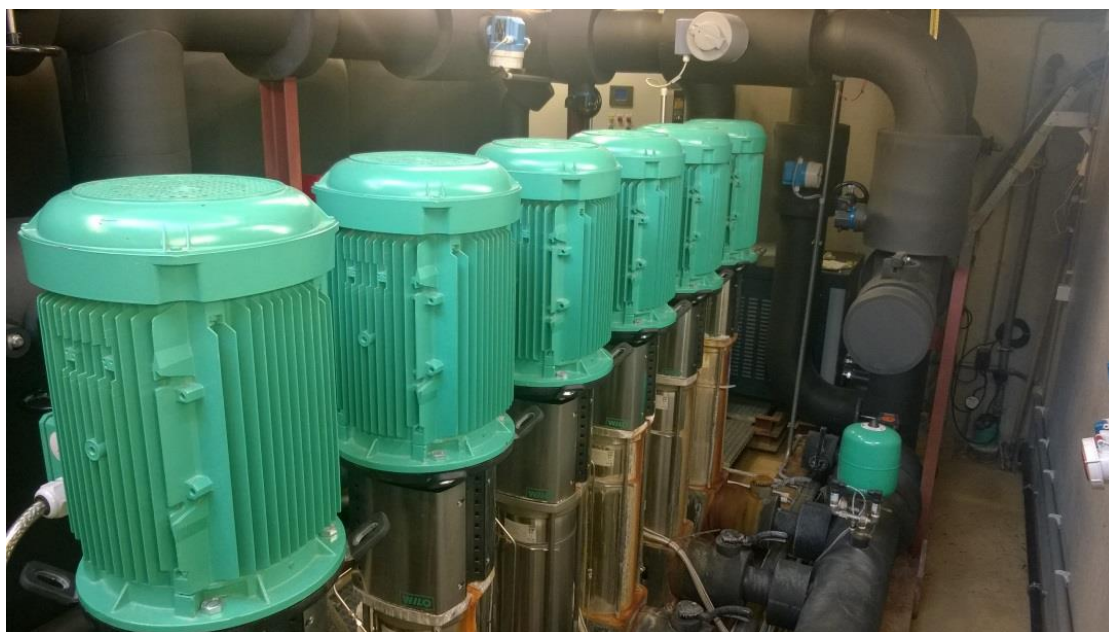
Figuur 34 - Opstelling van pompen in een ondergronds pompstation van Mijnwater
