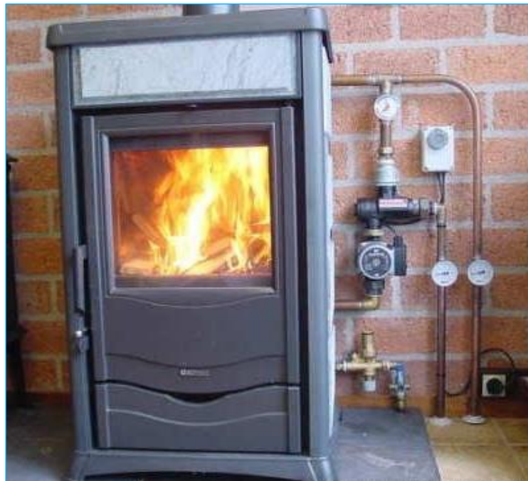
Figuur 12 Houtkachel aangesloten op CV-installatie
