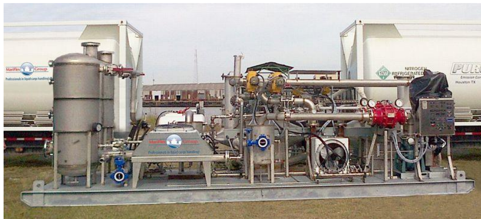
Figuur 2 Installatie voor behandeling emissies ontgassing
