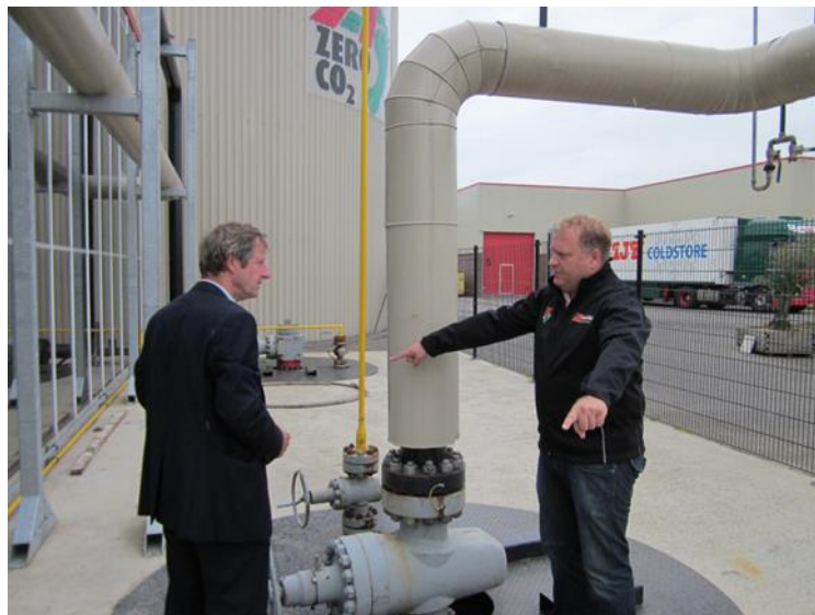
Figuur 16 Geothermie installatie bij Ammerlaan in Pijnacker
