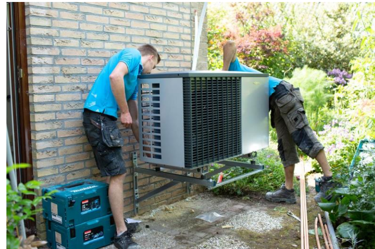
Figuur 5 - Buitenunit warmtepomp
