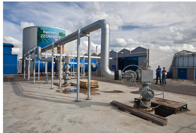
Figuur 15 - Geothermie installatie (bovengronds)
