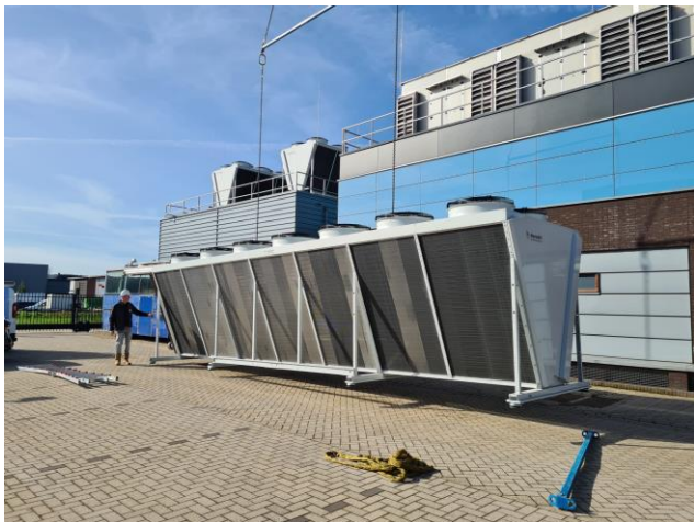
Figuur 13 - Drycooler wisselt warmte met de buitenlucht ter regeneratie WKO
