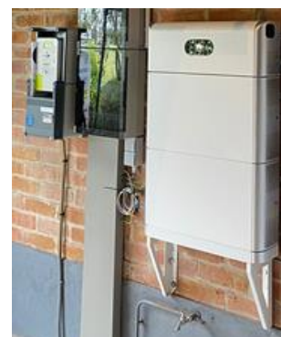
Huawei-omvormer en -thuisbatterijen (10 kWh) (MR Solar)
